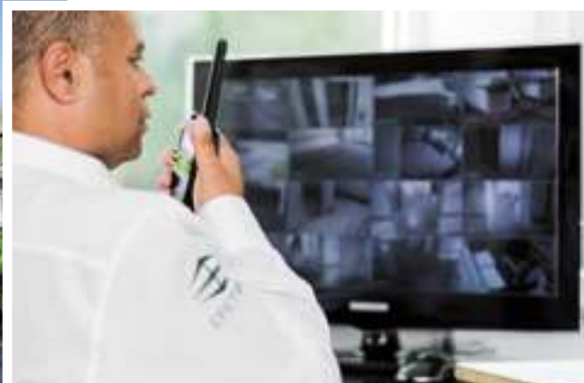
Central de monitoramento
